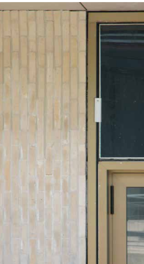
De lichte gevelsteen is in een halfsteensverband geplaatst na de installatie van de grote raampartijen. Knutselwerk-met-pastukjes was dan ook uit den boze.
